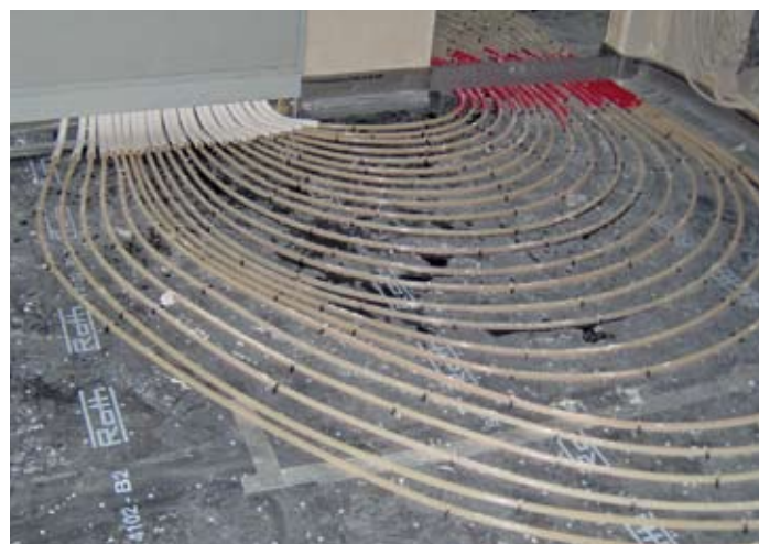
Die Fußbodenheizung für Kellerräume, Ober- und Dachgeschoss wird über den Schichtenspeicher versorgt. Insgesamt wurden 7500 m Fußbodenheizung auf ca. 1169 m 2 Fläche verlegt
