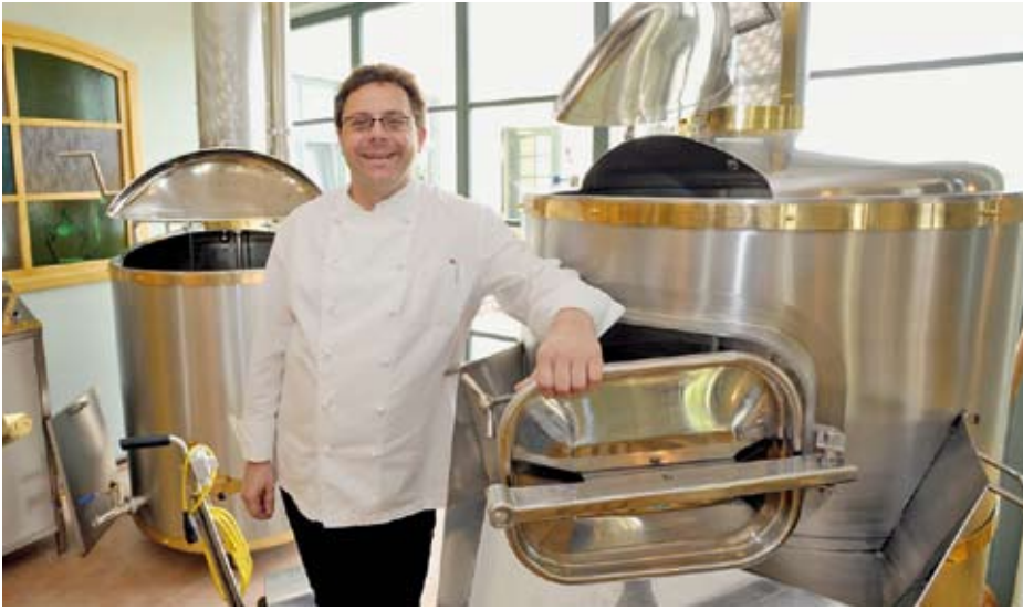
Andreas Ufertinger braut zweimal pro Woche. Die Anlage ist in das Energiekonzept integriert, die Rückkühlung findet im 5000-Liter-Schichtenspeicher statt. Andreas Ufertinger beziffert die Energiekosten der Kühlung und der Heizung des gesamten Komplexes auf ca. 2000 Euro jährlich
