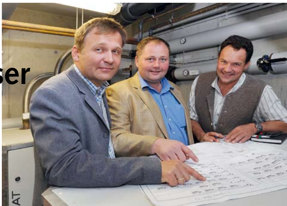
In den Neubau der Brauereigaststätte und des Tagungshotels St. Afra wurde komplexe Energietechnik eingebaut: Stefan Koch von der ausführenden Firma Reko-Tech, Ciat-Vertriebsleiter Max Sappl und Planer Josef Hacher (v.l.n.r.) sind stolz auf „ihre“ Anlage
