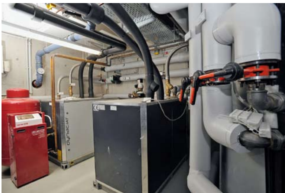
Das „Herz“ der Anlage bilden die zwei Wärmepumpen vom Typ Dynaciat 300 V
