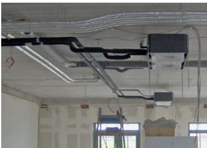
Zur Kühlung werden im Erdgeschoss die Deckenkassettengeräte Melody WA 63 und WA 123 2 TFC eingesetzt. Darüber und über die Fußbodenheizung wird auch die Abwärme des Brauprozesses nutzbar gemacht
